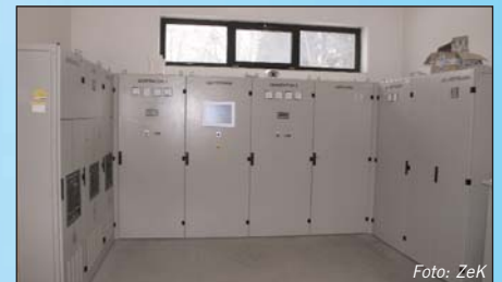
Sämtliche Anlagenteile sind vernetzt und lassen sich von mehreren Orten aus steuern.
