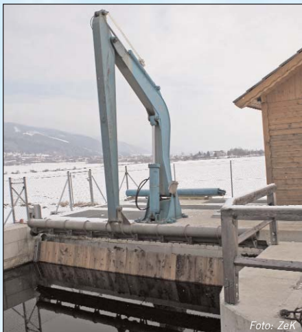
Rechenreinigung vor den Druckrohrleitungen
